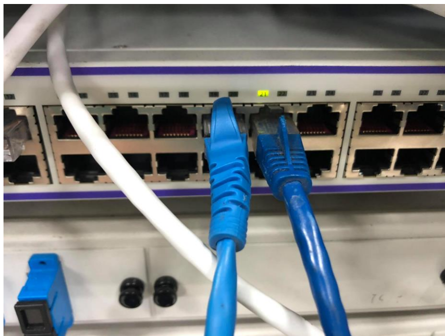
ภาพที่ 4.71 แสดงการเสียบสาย Uplink ที่เชื่อมมาจากอุปกรณ์สลับสัญญาณตัวหลัก
