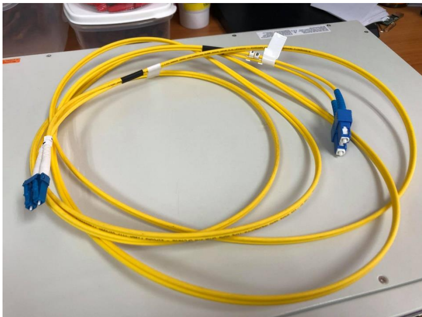
ภาพที่ 4.50 แสดงสาย Patch Fiber Optic
