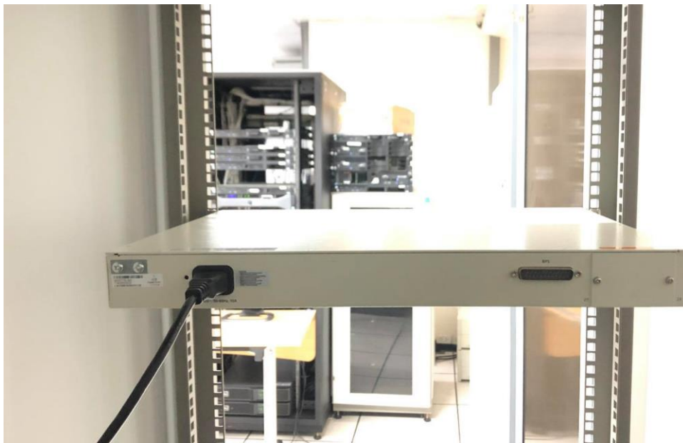
ภาพที่ 4.69 แสดงด้านหลังของการติดตั้งอุปกรณ์สลับสัญญาณ (Switching)
