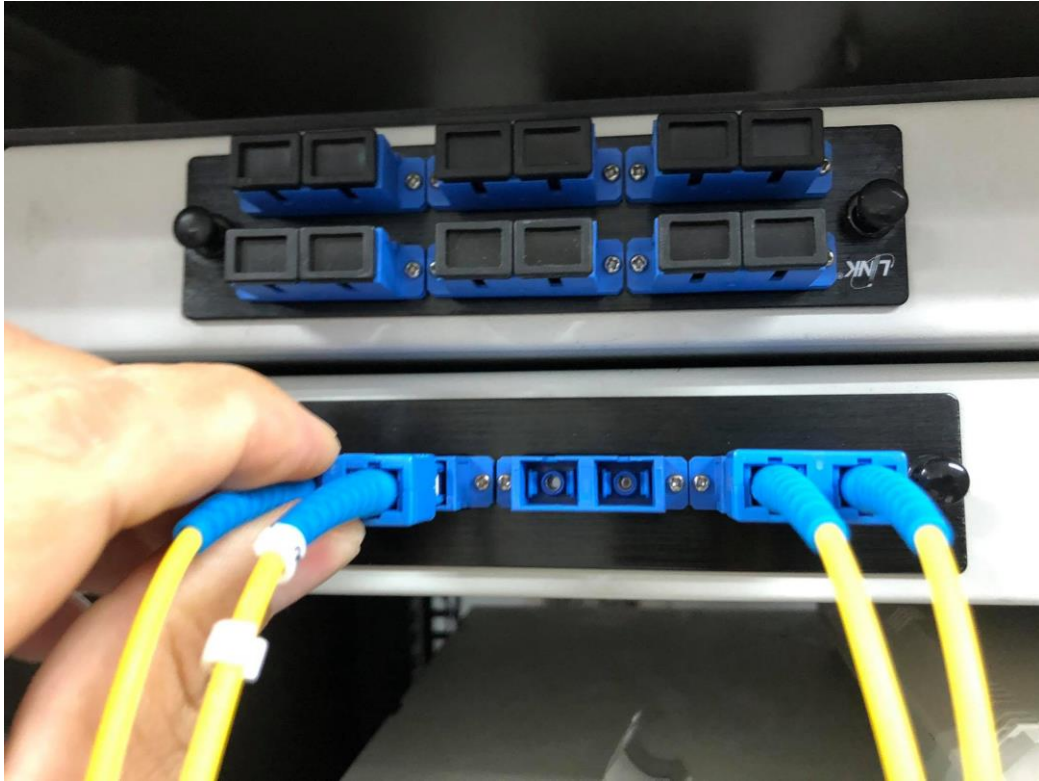
ภาพที่ 4.74 แสดงการเสียบสาย Fiber Optic เข้ากับตู้ Patch Fiber Optic สายขั้วต่อสำหรับสาย Patch ประเภทต่าง ๆ (ดังภาพที่ 4.75)
